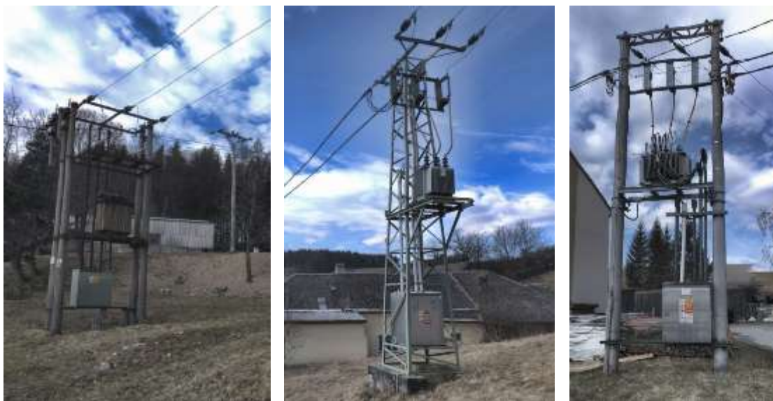
Obrázek 14 – Trafostanice v obci Rudná
